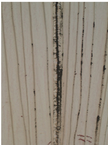
Figura 2. Cordão de solda com acúmulo de sujeira e oxidação.
